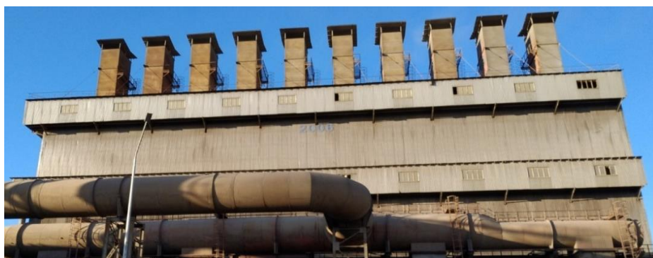
Рисунок 8 – Вытяжные шахты для выхода очищенного газа на газоочистке 15 и 17 печи.
